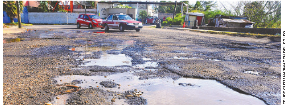
LA PARTE MÁS DAÑADA POR BACHES es la también conocida 'Carretera Antigua a Mina', a la altura de la colonia Benito Juárez Norte.
