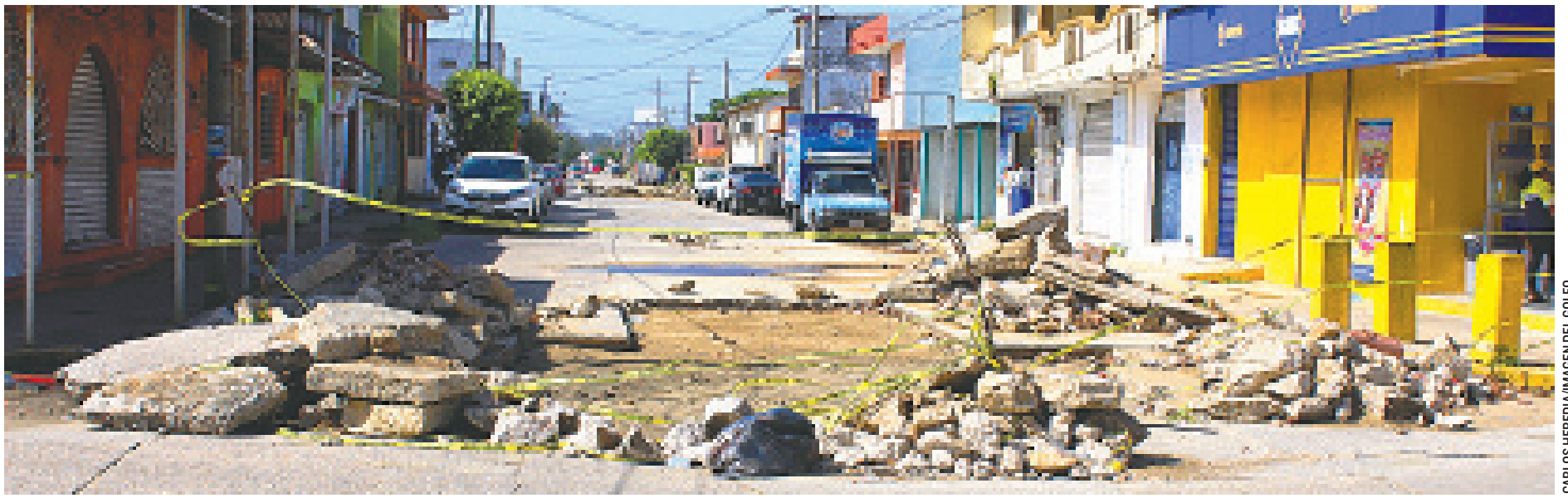
ESTE HUNDIMIENTO UBICADO EN LA AVENIDA QUEVEDO, esquina con Platón Sánchez, lleva 6 meses.
