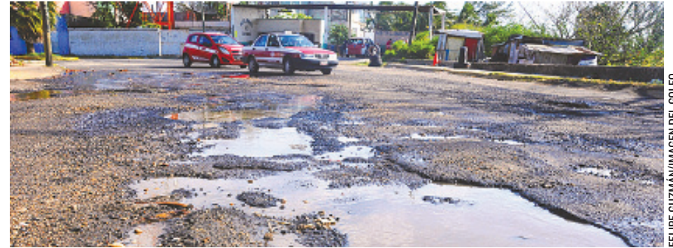
LA PARTE MÁS DAÑADA POR BACHES es la también conocida 'Carretera Antigua a Mina', a la altura de la colonia Benito Juárez Norte.
